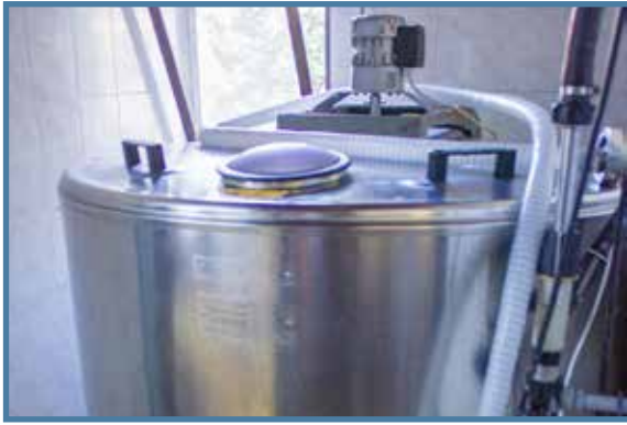
Fig. 54 | Serbatoio di refrigerazione in buone condizioni di manutenzione
